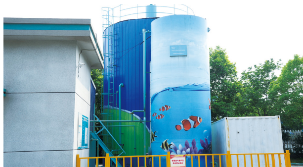
公司湖州生产基地污水处理的厌氧塔
